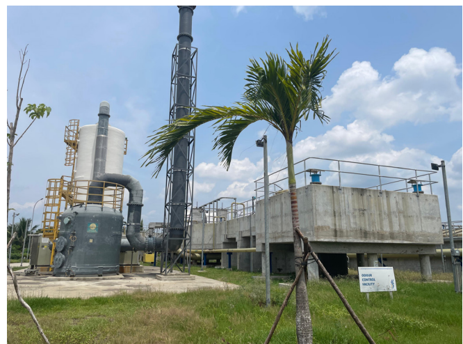
Anaerobic Baffled Reactor dan Pengendali Bau
