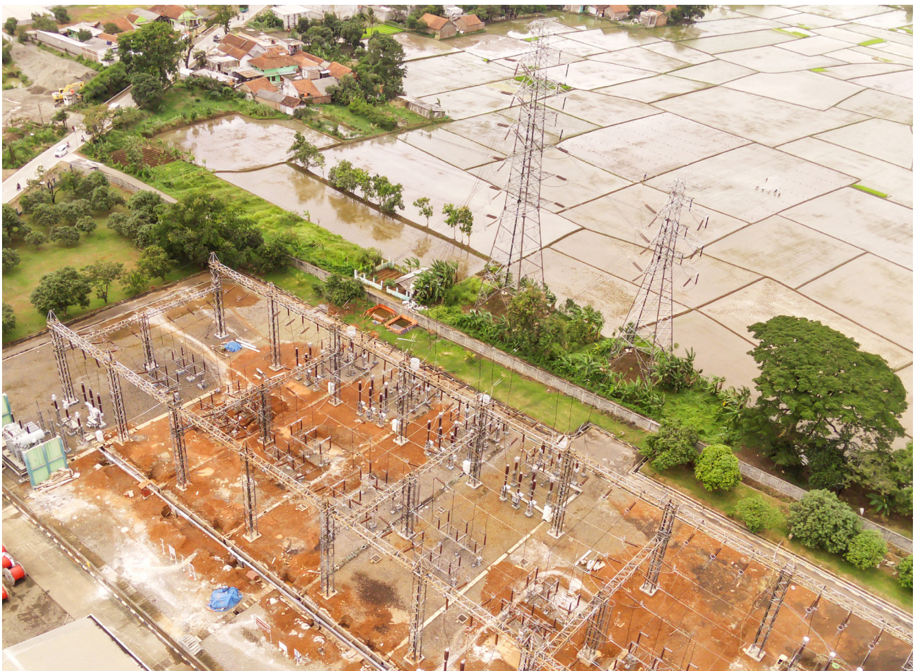
Stasiun distribusi tenaga listrik
